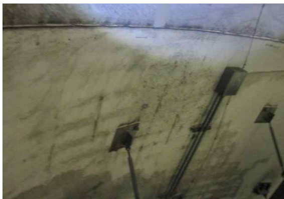
라이닝 SPAN.20 와이어매쉬 노출
