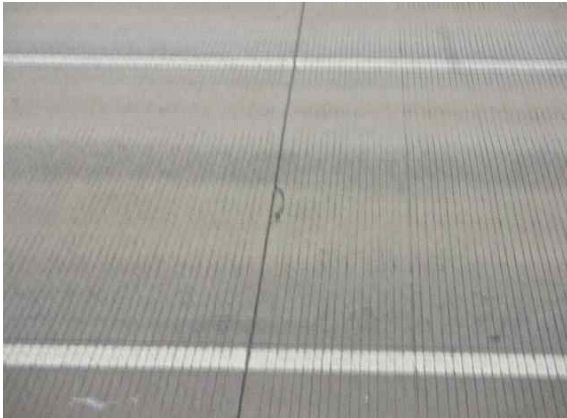
포장부 SPAN.88 파손
