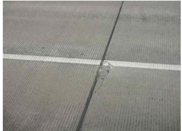
포장부 SPAN.115 파손
