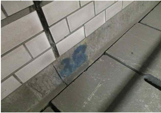
라이닝 SPAN.38 균열(0.3mm 이상)
