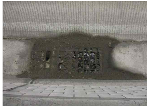
배수시설 SPAN.131 집수구 토사퇴적
