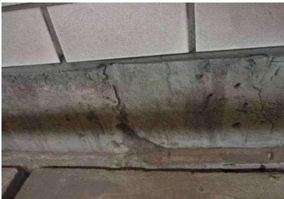
라이닝 SPAN.71 균열(0.3mm 이상)
