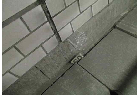
라이닝 SPAN.58 균열(0.3mm 이상)
