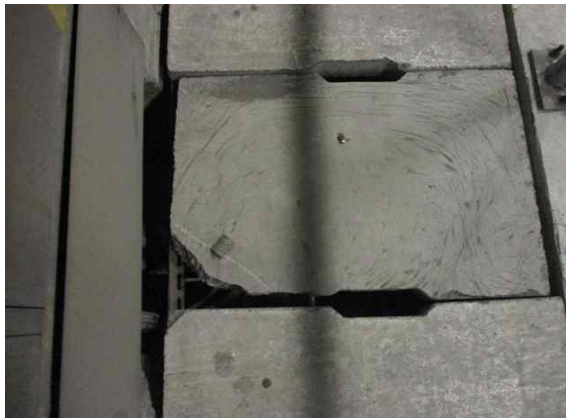
공동구 SPAN.128 덮개 파손
