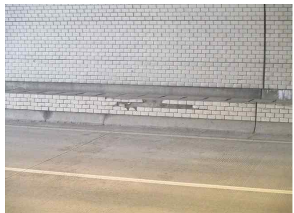
측벽부 SPAN.137 타일 탈락
