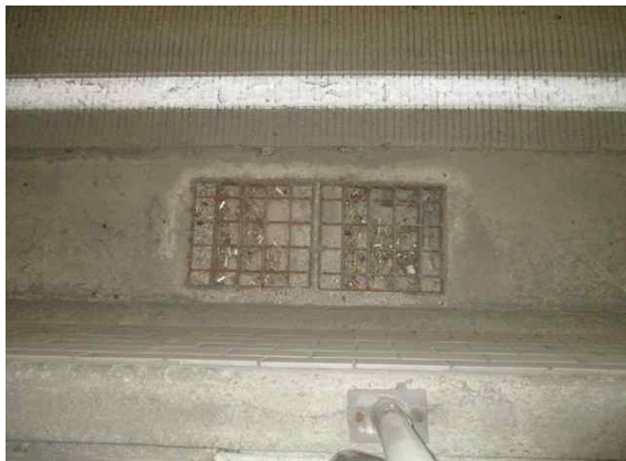
배수시설 SPAN.54 집수구 토사퇴적
