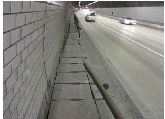
공동구 SPAN.100 난간 파손
