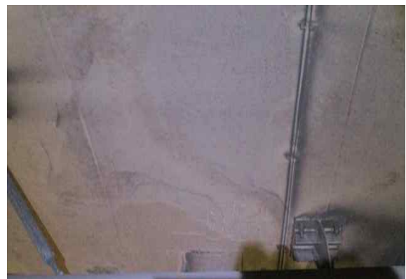
라이닝 SPAN.124 균열(0.3mm미만)
